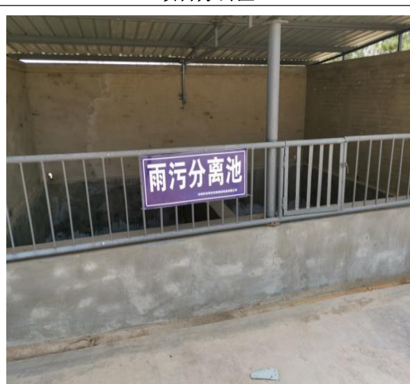
项目区雨污分流池
