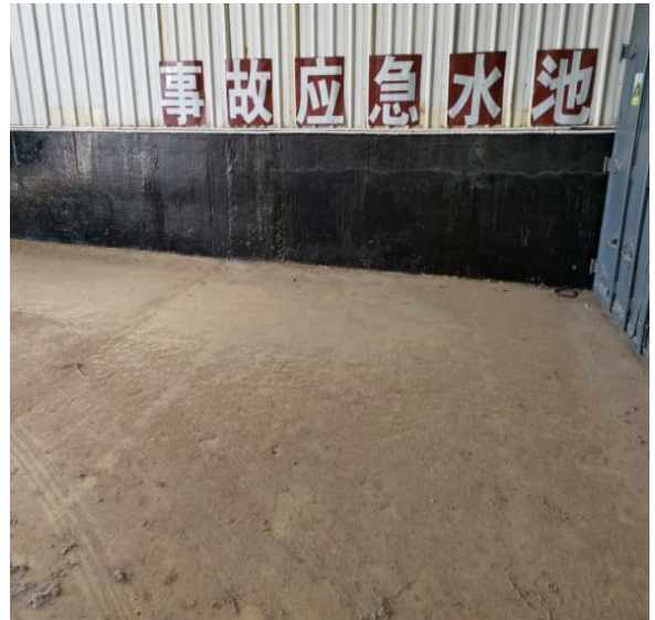
仓储内地埋式事故应急池
