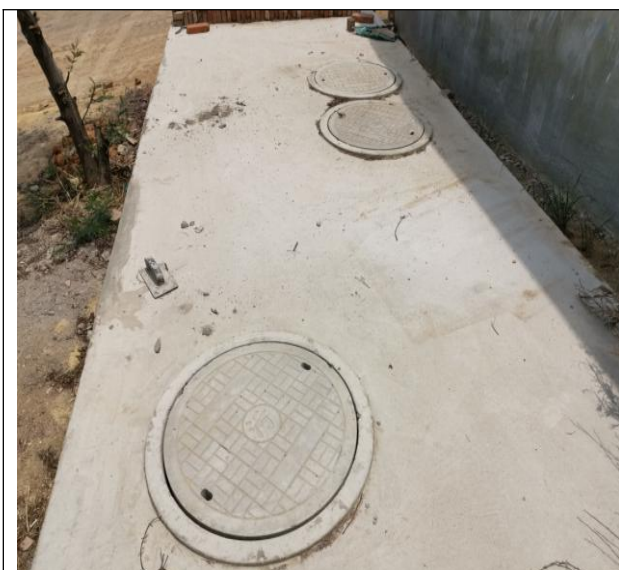
项目 50m 3 地埋式化粪池
